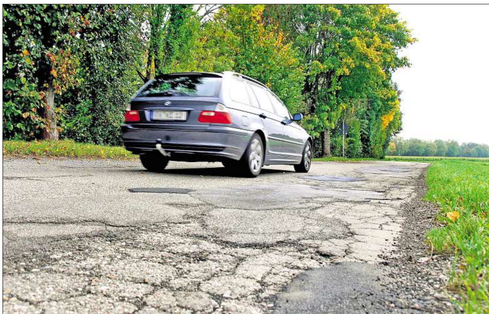
FLICKENTEPPICH: Immer mehr Straßen sind in einem schlechten Zustand, wie hier die Gemeindestraße zwischen Weitenung und Halberstung. Der Verband der Bauwirtschaft Baden-Württemberg präsentierte gestern in Bühl einen Lösungsvorschlag. Foto: Margull
