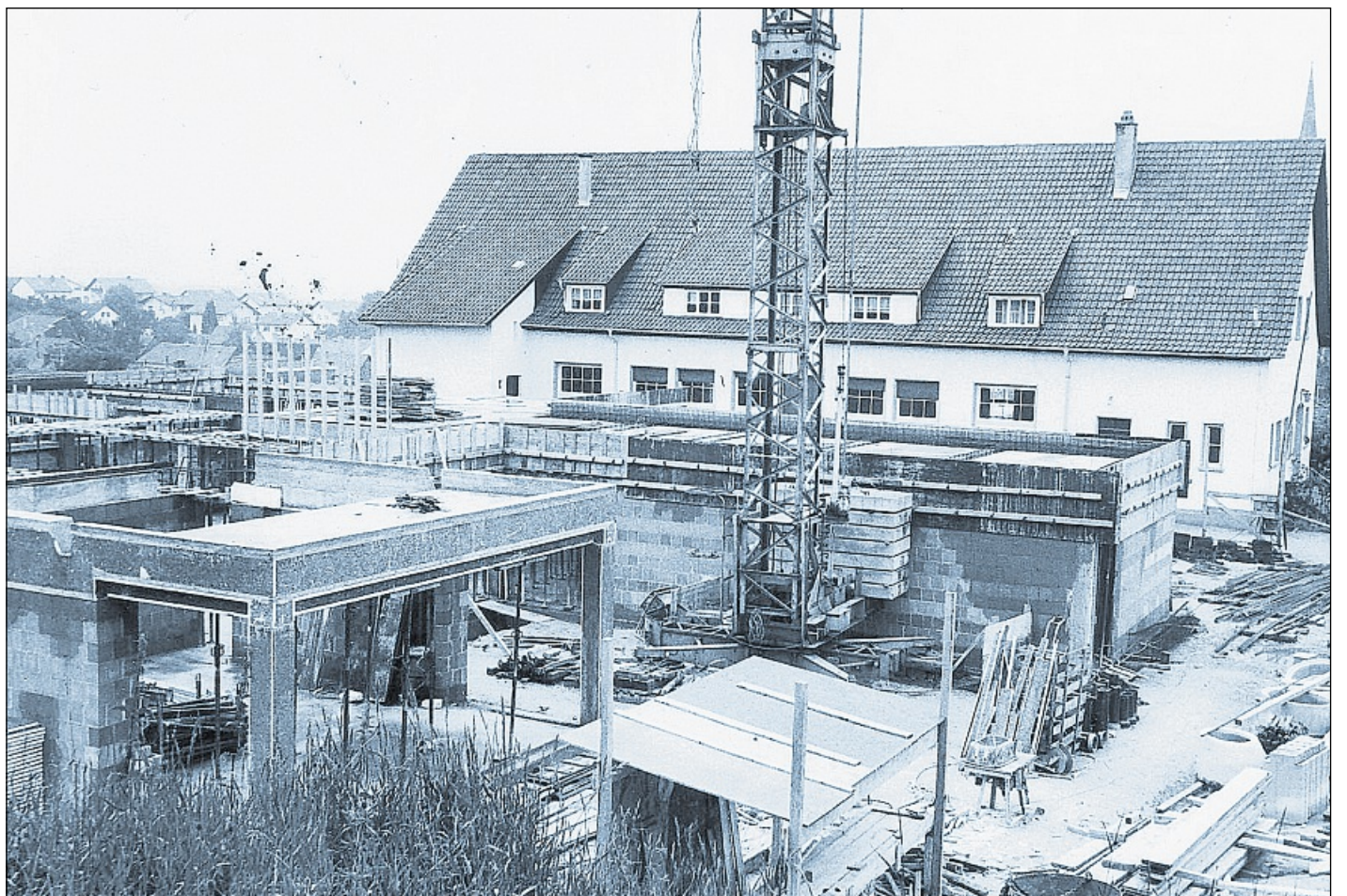
BAUARBEITEN: Nach rund einem Vierteljahrhundert wird Mitte der 1970er Jahre der neue Kindergarten, wie er heute besteht, errichtet. Im Hintergrund das Marienhaus, in dem der Kindergarten seit Anfang der 1950er Jahre untergebracht war. Foto: Archiv
