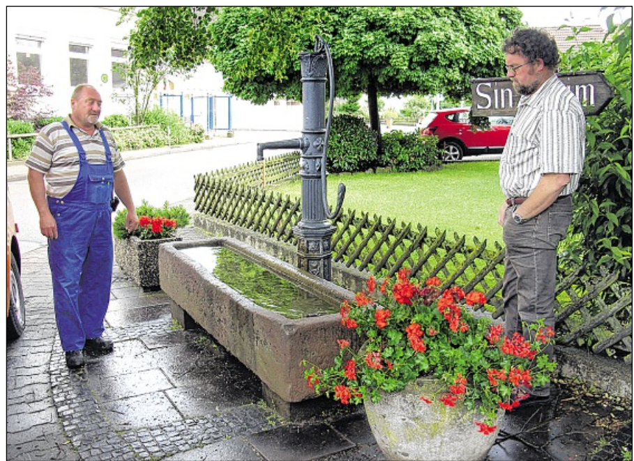
AUSSER FUNKTION: Der Dorfbrunnen in Halberstung wurde durch unbekannte Vandalen beschädigt. Foto: Pr
