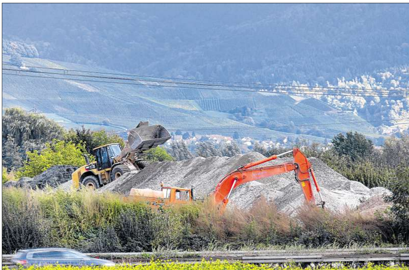
AUF DEM BAUHOF-GELÄNDE der Firma Via Solutions im Bereich der ehemaligen Rosenzucht Sulzer wird Bauschutt gelagert. Die Bürgervereinigung Halberstung kritisiert die Belastungen für die Menschen im Dorf. Foto: Vögele
