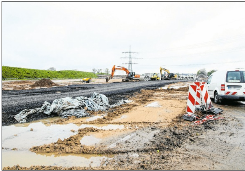
HINTER DEM LÄRMSCHUTZWALL entsteht ein neuer Lkw-Parkplatz. Insgesamt sollen künftig 136 Parkplätze für Lkw, Busse und Caravans zur Verfügung stehen.
