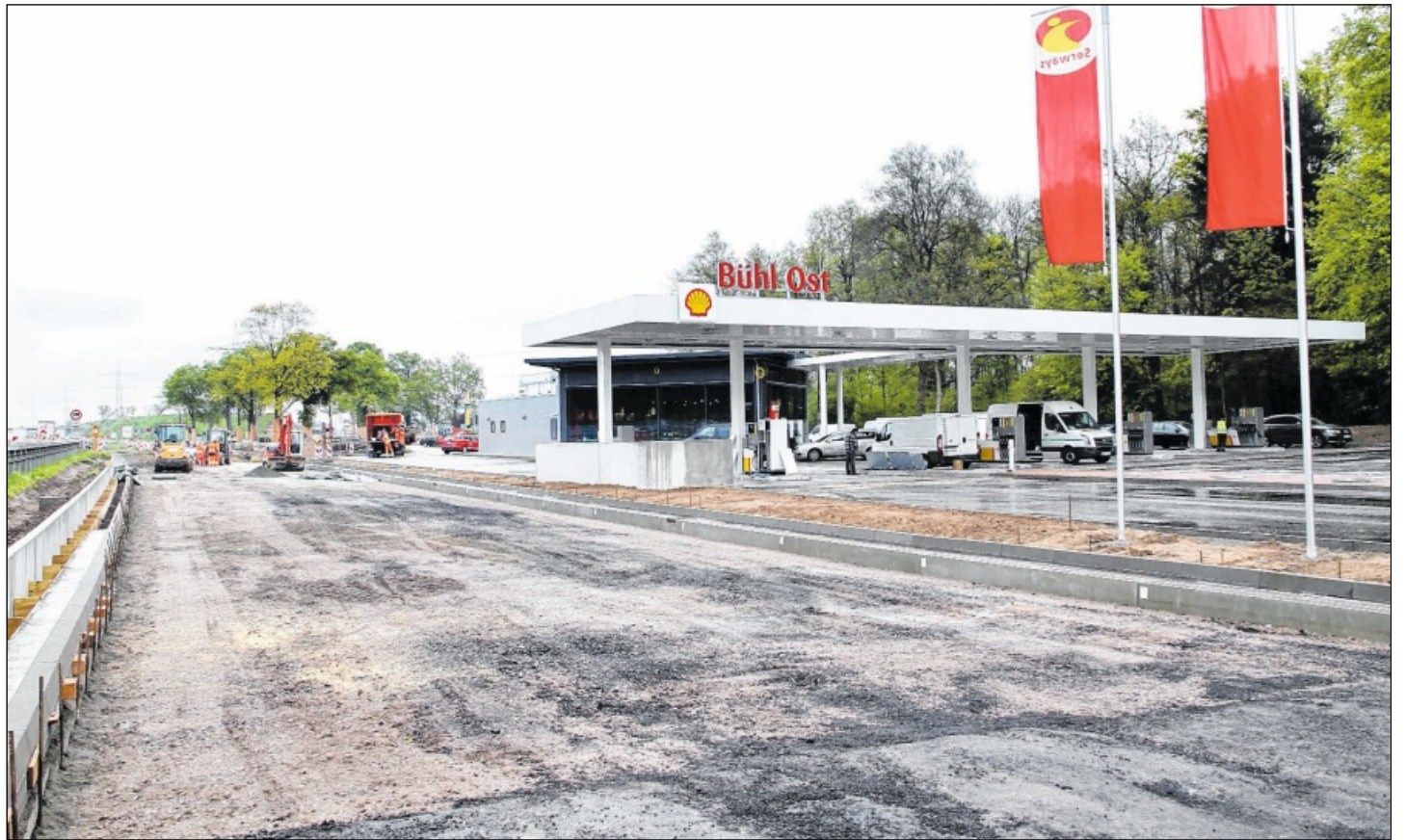
EINE NEUE TANKSTELLE wurde parallel zu den Erweiterungsarbeiten am Rasthof Bühl errichtet. Sie soll bereits an diesem Samstag öffnen. Fotos: Bernhard Margull
