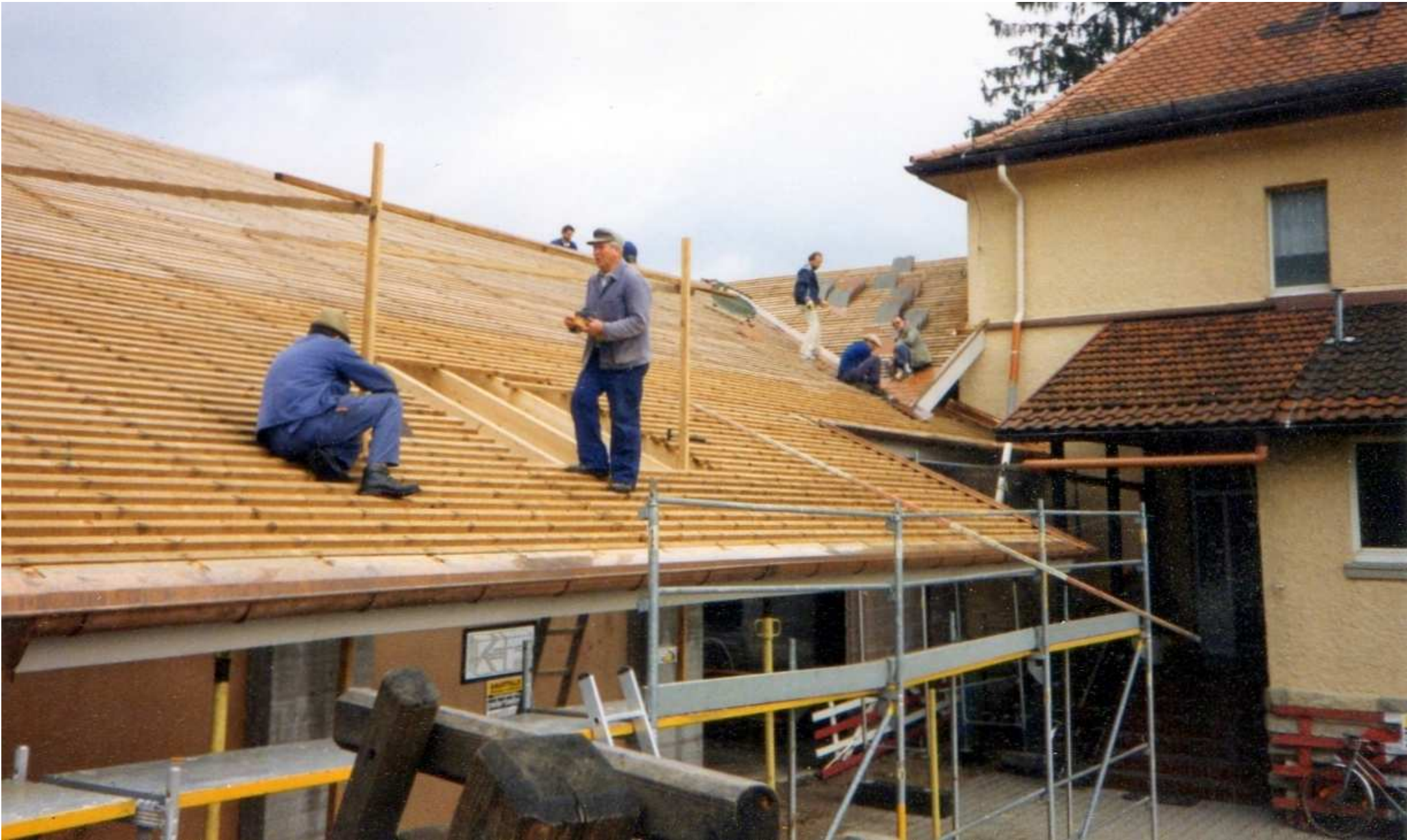
Die Zimmerleute Willi Meier (sitzend, li.) und Martin Ernst treffen gerade die Vorbereitungen für den Abbund der Dachgaube am Hallendach. Im Hintergrund sind Dachdeckungsarbeiten am Bühnengebäude im Gange
