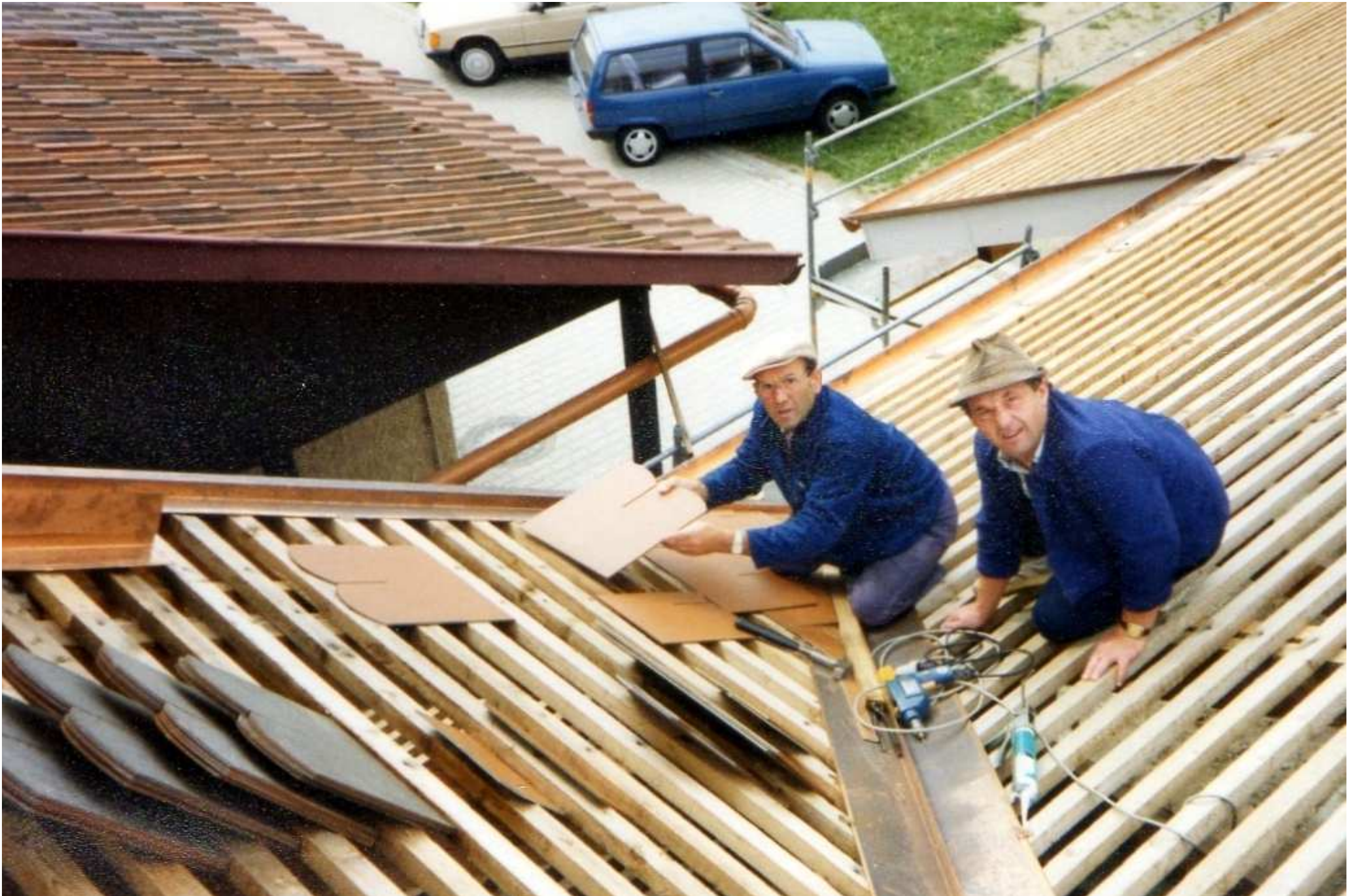
Hermann Ganter (li.) und Günter Prestenbach – der am 13. Juli 2015 seinen 75sten gefeiert hat – bei Eindeckung der Dachfläche im Kehlbereich des Anschlusses Halle/Bühnengebäude.
