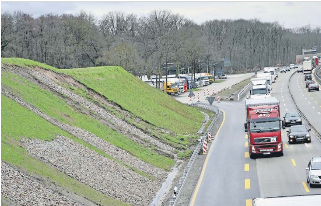
Warnbaken weisen auf die Schäden hin: Teile des Lärmschutzwalls nahe der Raststätte Bühl sind abgerutscht. Im Vordergrund ein bereits stabilisierter Abschnitt. Foto: Margull
