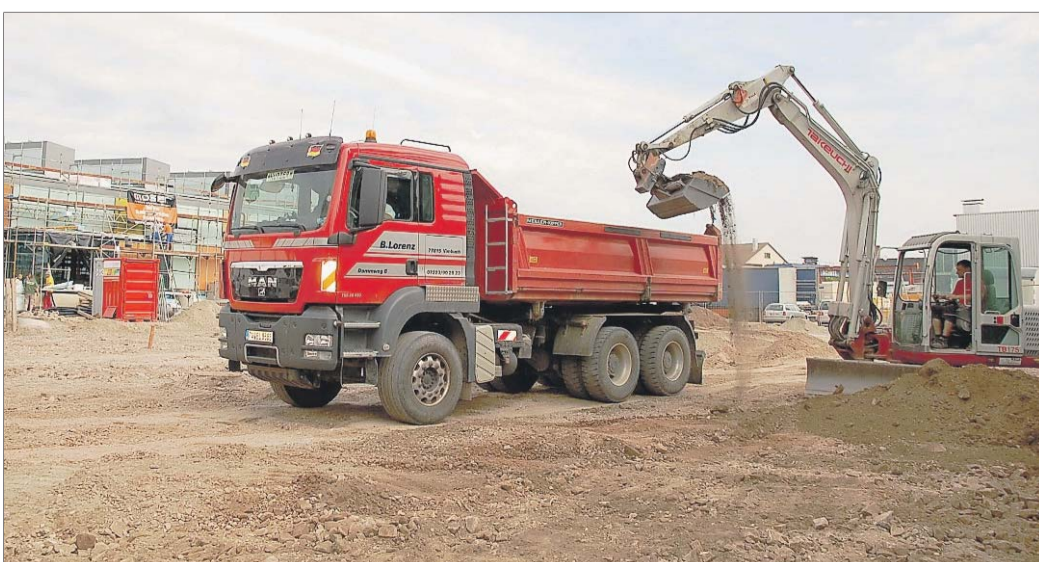
Der Innenausbau der neuen Großsporthalle ist noch in vollem Gange, da haben bereits die Arbeiten für die Gestaltung der Außenanlagen begonnen.
