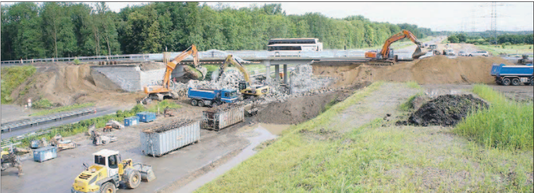
Über die neue Brücke rollt der Verkehr, die alte liegt in Trümmern: Gesperrte A 5 bei Halberstung.
