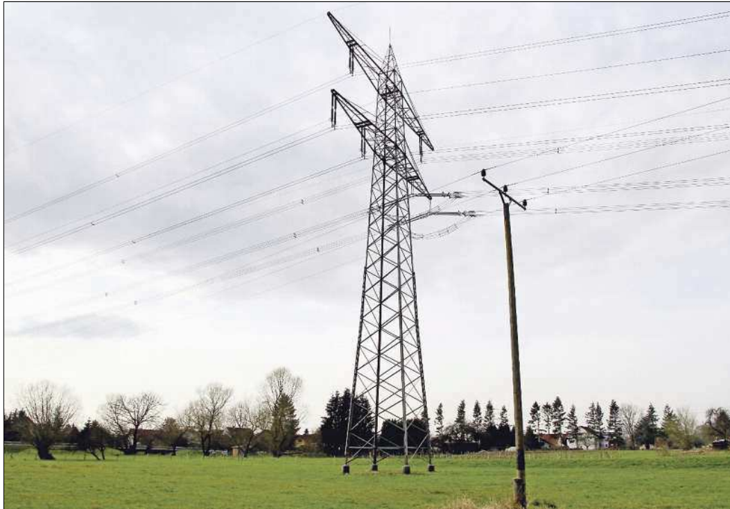
Aufgrund der Energiewende soll die 220-Kilovolt-Leitung, die nahe an Halberstung vorbei führt, auf 380 Kilovolt verstärkt werden.
